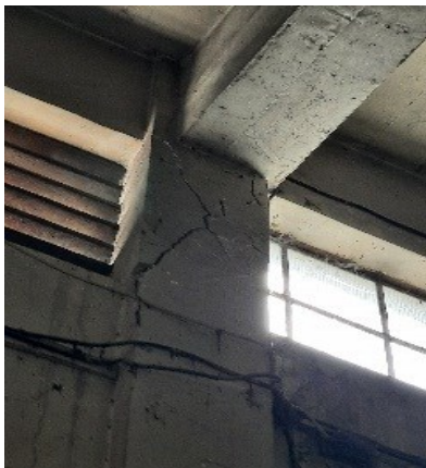
الشكل (14): انهيار القص
