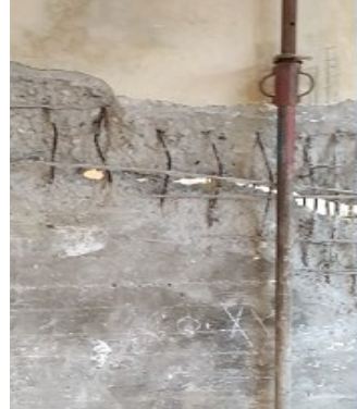
الشكل (20): انهيار جدران القص
