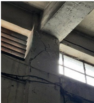
الشكل (14): انهيار القص
