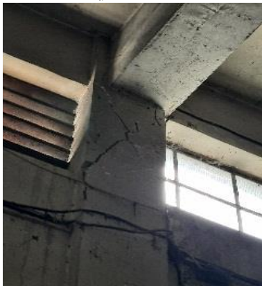
الشكل (14): انهيار القص
