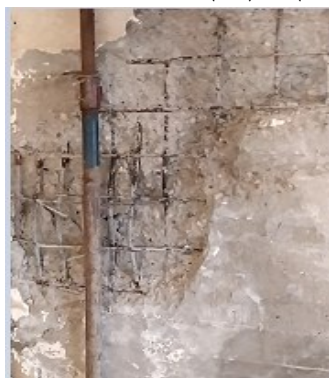
الشكل (21): انهيار جدران القص
