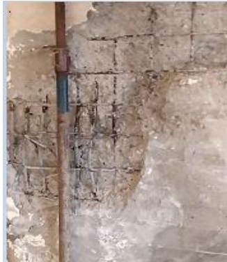
الشكل (21): انهيار جدران القص
